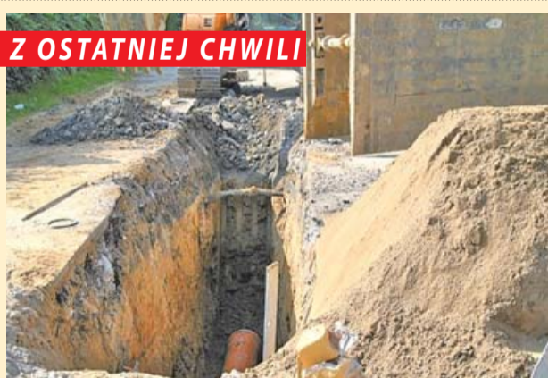
Z OSTATNIEJ CHWILI Trwają prace przy kanalizacji na ul. Kruczej. Stosowane obecnie rozwiązania są zgodne z najnowszymi trendami technologicznymi a także wyróżniają się mając wyjątkową sprawnością, wysoką drożnością, co wyeliminuje dotychczasowe częste awarie.
