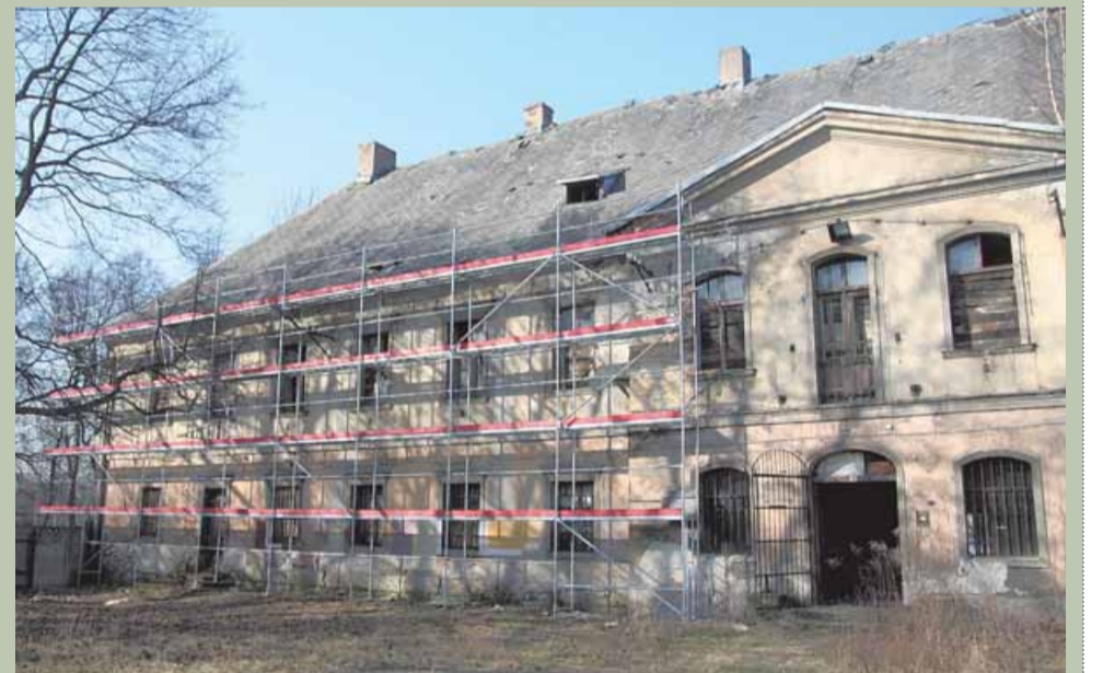
Przy pałacu Mieroszewskich / Donnersmarcków stanęły rusztowania. To widomy znak, że ruszyły z dawna oczekiwane prace remontowe. Obecny właściciel pałacu, firma „Saternus”, ma ambitne plany. Czy zdoła je zrealizować? Trzymamy kciuki! Warto w tym miejscu przypomnieć, że w ubiegłym roku uchwałą Rady Miasta wprowadzono zmiany do Lokalnego Programu Rewitalizacji, tak aby umożliwić właścicielowi pałacu ubieganie się o środki unijne na jego remont.
